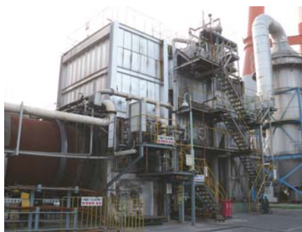
旋转窑焚烧炉 (实施蒸气回收)
